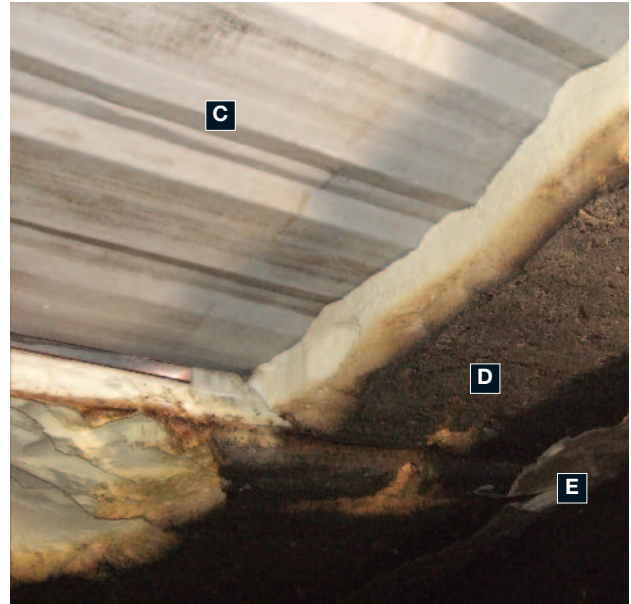
C : Tijdelijke dakbedekking over gat in het dak. D : PIR-kern met delaminering van het onderste oppervlak en de diepte van de verkoling. E : Snijrand van de onderste stalen laag van het sandwichpaneel.
